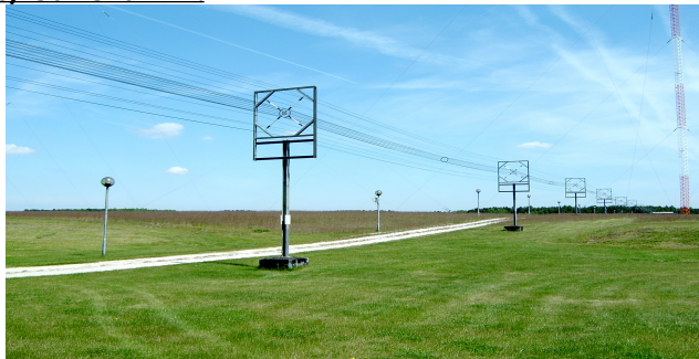
Κεραία και γραμμή μεταφοράς σταθμού Πολωνικού σταθμού, LW στους 225 KHZ.
